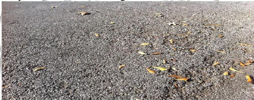
Fig. Raveling (very porous asphalt)
