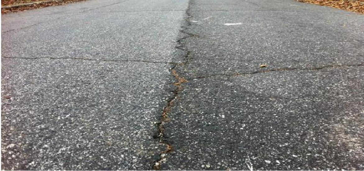
Longitudinal (Linear) Cracking
