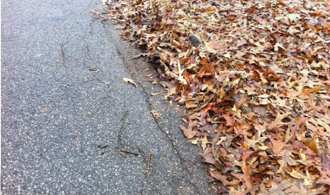
Fig. Edge Cracks
